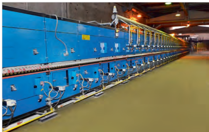
Энергосберегающая печь «SACMI»
